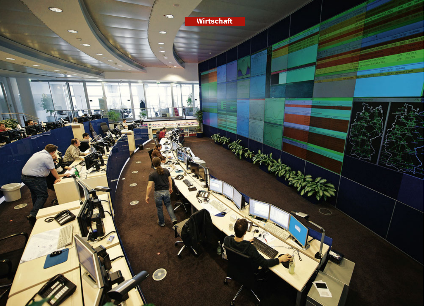
Steuerungszentrale des T-Mobile-Funknetzes in Bonn: „Turbulent und stressig“
