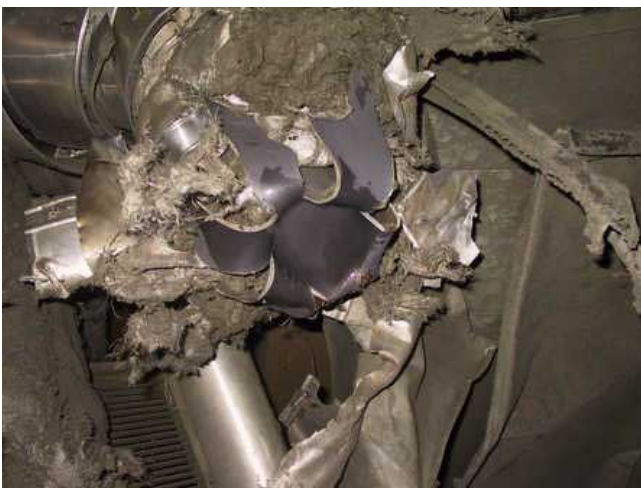
Explodierte Rohrleitung: „Spontane Leckage“
