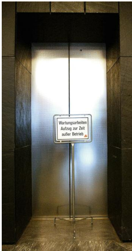
Wartungsbedingt stillgelegter Aufzug Zahlen müssen die Mieter
