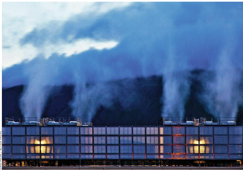
Google-Rechenzentrum in Oregon: „Die neuen Systeme sind Datensauger“
